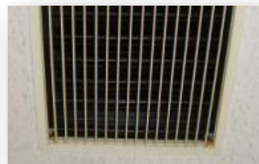
還気口→換気ダクト→空調機
